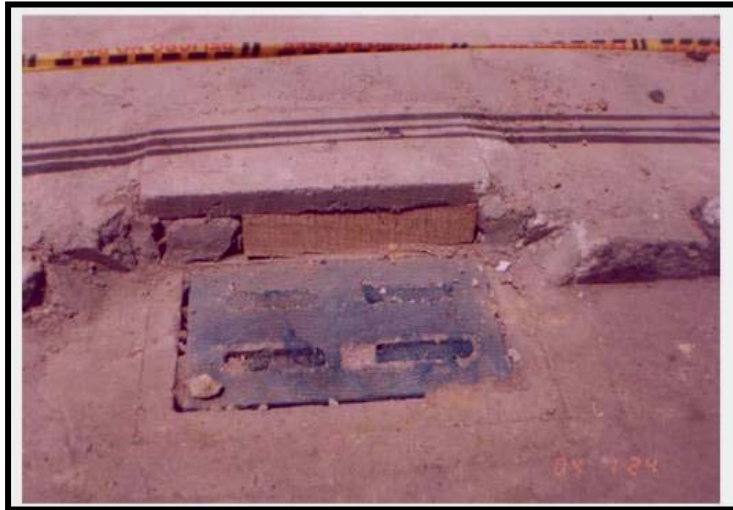
Figura 8.20 protección de sumideros
