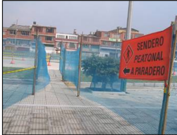
Figura 8.18 Señalización de Transito Peatonal
